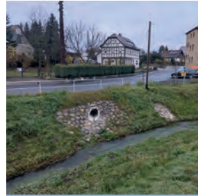
Regenwasserkanal Untere Dorfstraße
