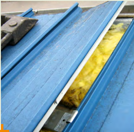
Sturmschaden am Dach der Sporthalle Niederoderwitz
